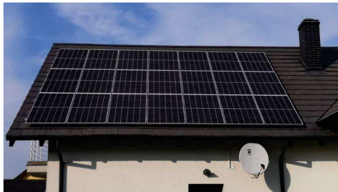
Panele fotowoltaiczne na prywatnej posesji na terenie gminy Barcin
